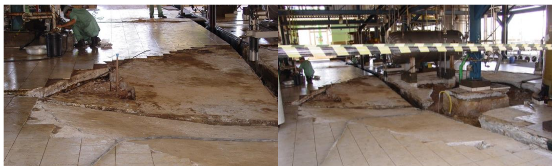
Figura 3. Afundamento do piso provocado pelo colapso do solo.
