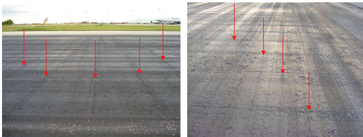
Figura 8. Danos provocados no pavimento pelos equipamentos de remoção de borracha
