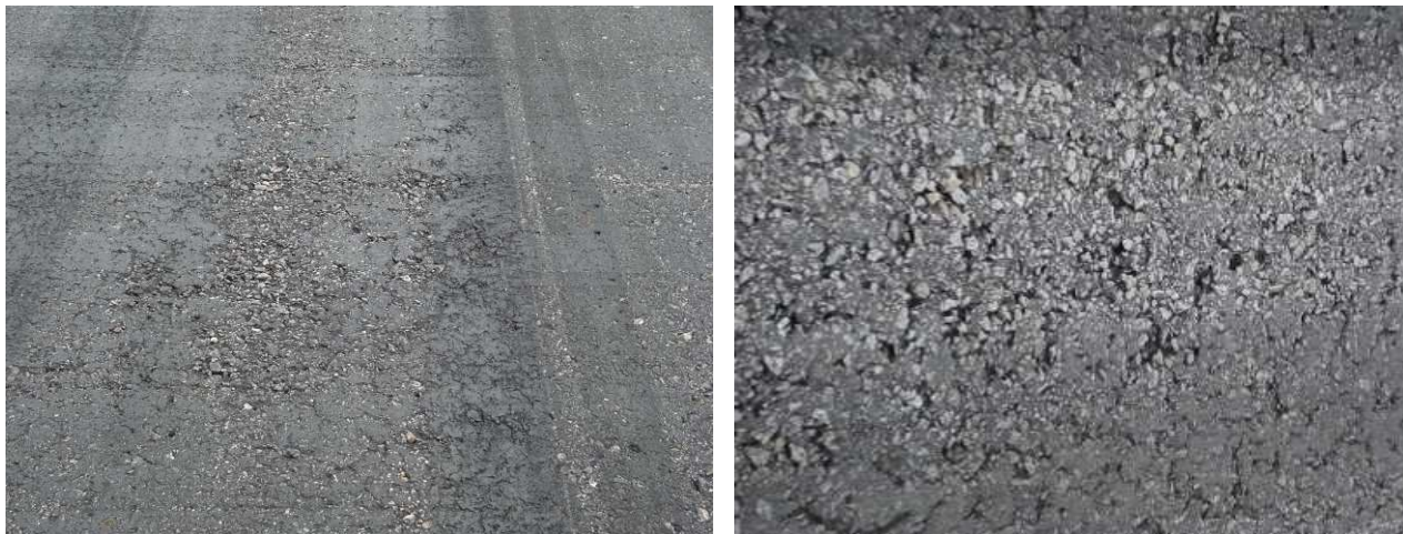
Figura 7. Deterioração do pavimento
