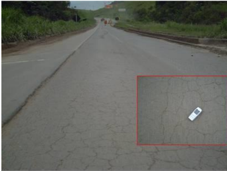
Figura 8: Visão do revestimento após fresagem ineficiente.
