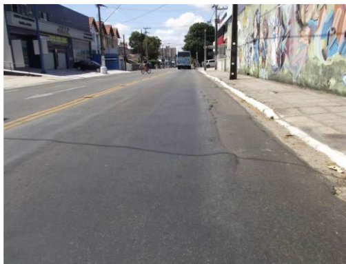
Figura 5. Afundamento com trilha de roda
