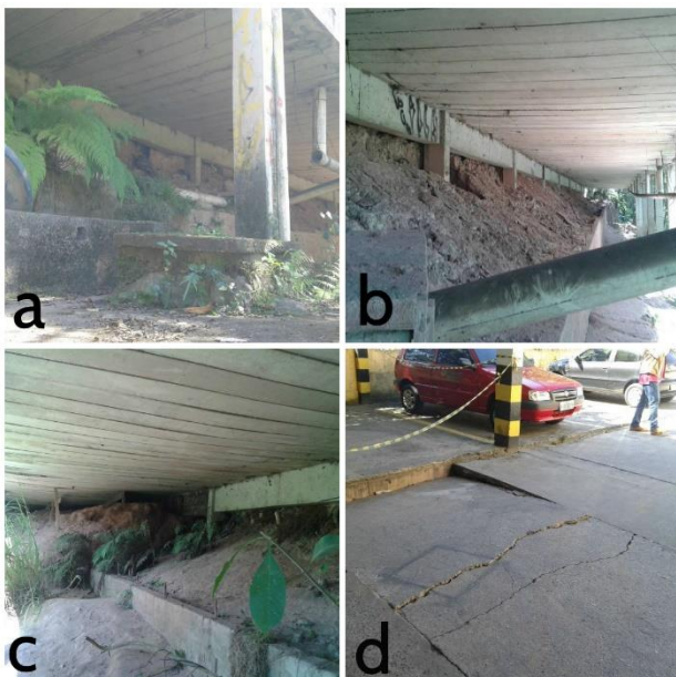
Figura 2 – Vista geral sob a estrutura de fundação e pilares com evidências de erosões, solo desconfinado, deformação das lajes e desaparecimento de pilares
