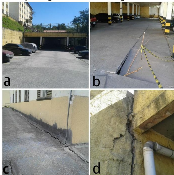
Figura 1 – Vista geral do local e evidências de solapamentos e fissuras em diferentes estruturas do condomínio
