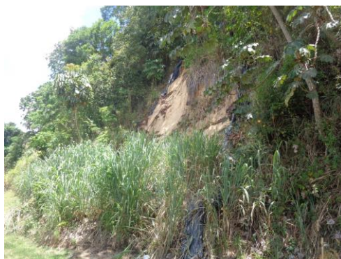
Figura 2. Cicatriz de rupturas recentes na parte inferior do talude.
