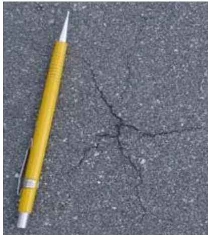
Figura 3. Exemplo de danos ao pavimento (“pé de galinha”) com escória utilizada na mistura do revestimento (Rodrigues, 2007 apud Tavares et al. , 201).
